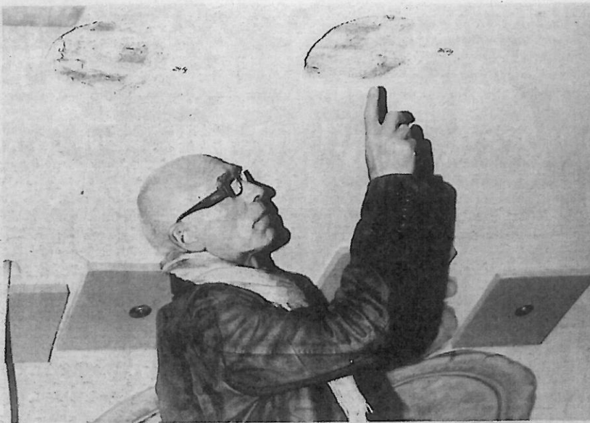
Felix Vögele weist auf eine Stelle an der Kirchendecke, wo eine Haftungsprobe vorgenommen wurde.
